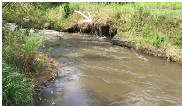
Gambar 8 Contoh talud sungai dengan fondasi yang sudah menggantung
